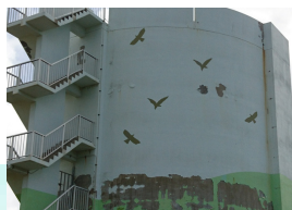
伊良部島の貯水タンク
